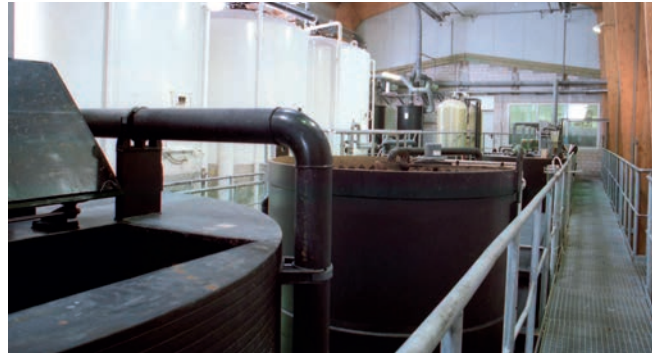
PE sewage plant
